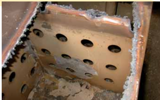
Sedimenti e residui sulle pareti e sul fondo di serbatoi per l'acqua. Fonte: ISPESL.
