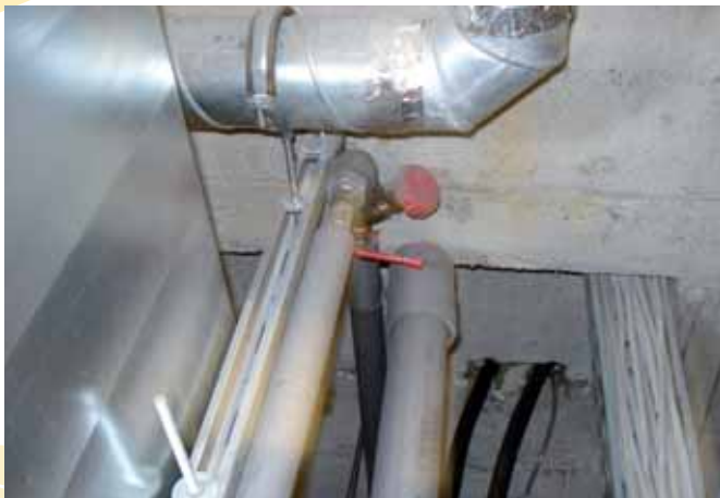
Circuito chiuso nascosto in un sistema di circolazione di acqua calda che consentiva lo sviluppo della legionella. Fonte: OMF1.
