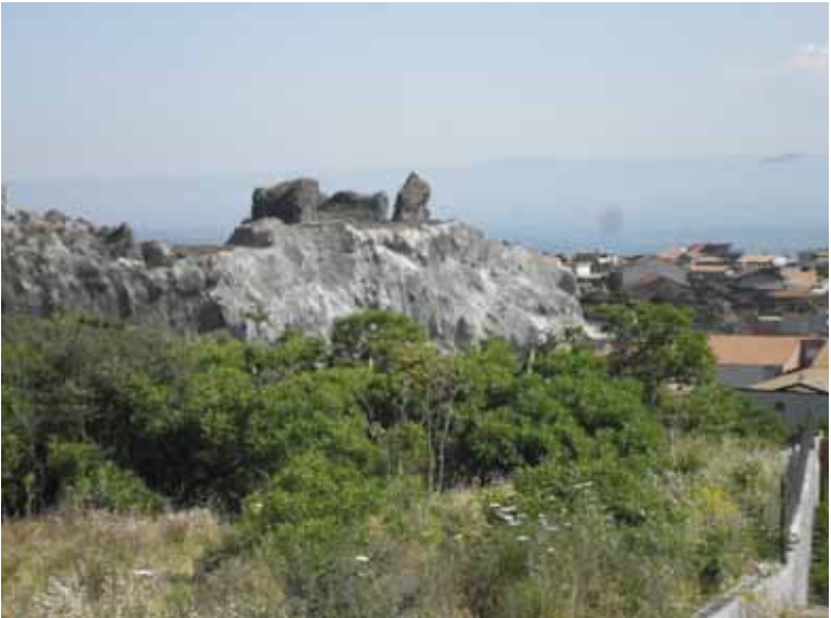
Figura 16. - La cava di Monte Calvario dopo l'intervento di bonifica realizzato mediante ricopertura con Spritz Beton.
